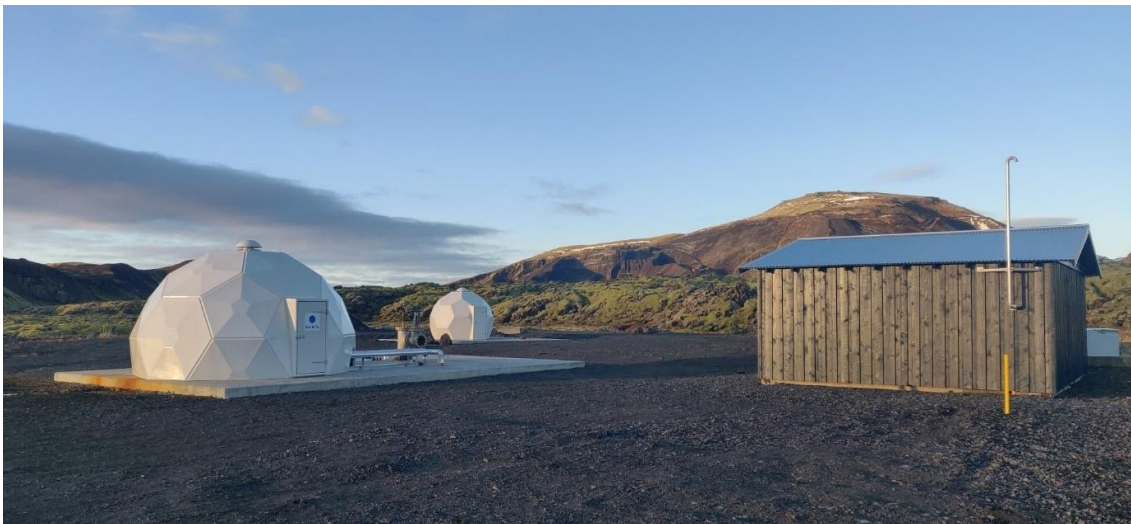
Mynd 5.3: Mannvirki niðurdælingarkerfis í Þrengslum. Fremra kúluhús skýlir holu HN-02.
